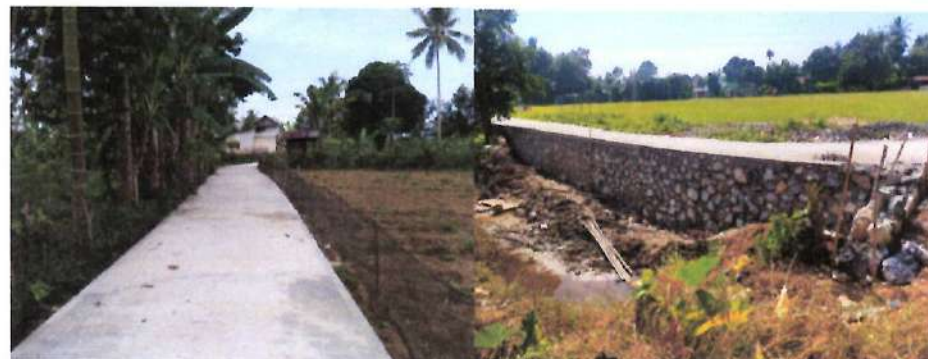
Gambar 20 Pembangunan Jalan Lingkung Taratak Padang Kampuang (Kiri), pemeliharaan jalan lingkung lapangan bola talawi
